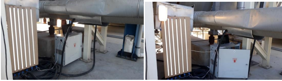
Şekil 4. Türkiye'de Çalışan İlk Akıllı Termoelektrik Atık Isı Santralin Görüntüsü.
