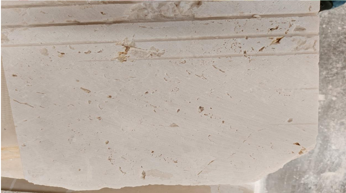
Şekil 2. Kırık-çatlak sistemlerinin genel görünümü
